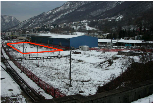
Übersicht Standort Rivera: Der Bereich, welcher im Rahmen der Teilsanierung ausgehoben wurde, ist rot umrandet.
